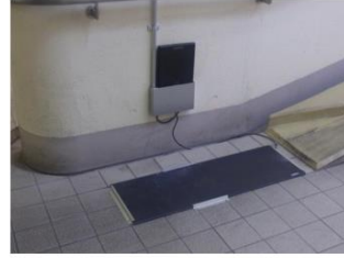
↑壁据え付け型アンテナ 及びマットアンテナ →
